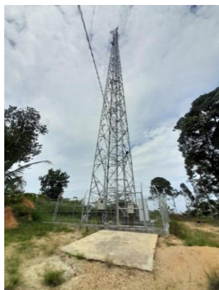
Tower Jaringan Telekomunikasi
