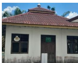
Kondisi Musholla (kaca, lantai dan plafon rusak)
