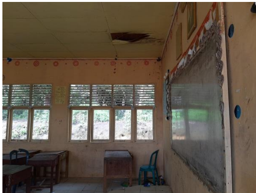
Ruang Kelas yang Rusak
