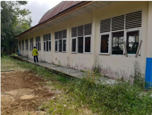
Kondisi Gedung Yang Rusak
