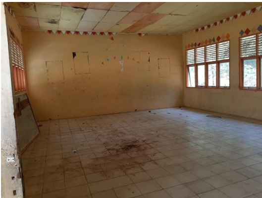
Ruang Kelas yang Rusak
